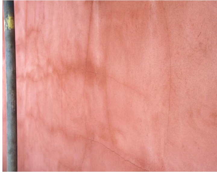
Figur 1 Sprickbildning hos puts utförd på ett eftergivligt underlag.
